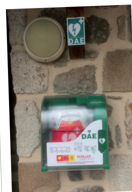
Défibrillateur installé sur le mur de la mairie
