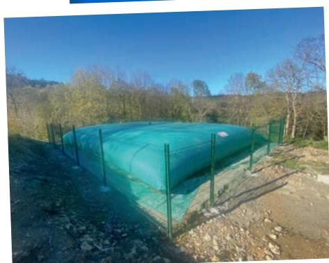
Réserve incendie de Colombette 120m 3
